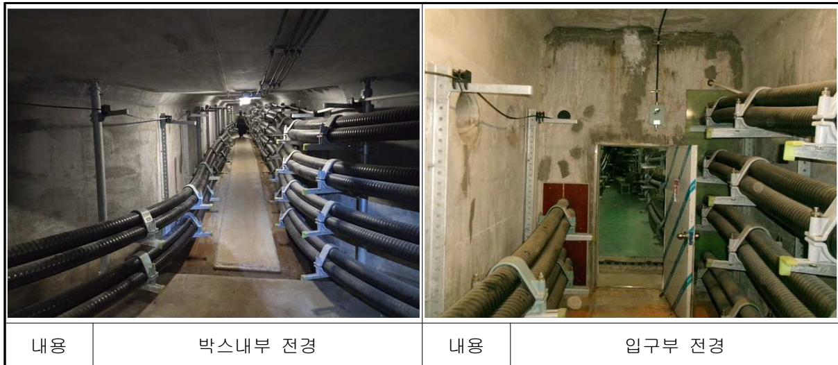
【사진 3.1】 문발SS인출 전력구 현황
