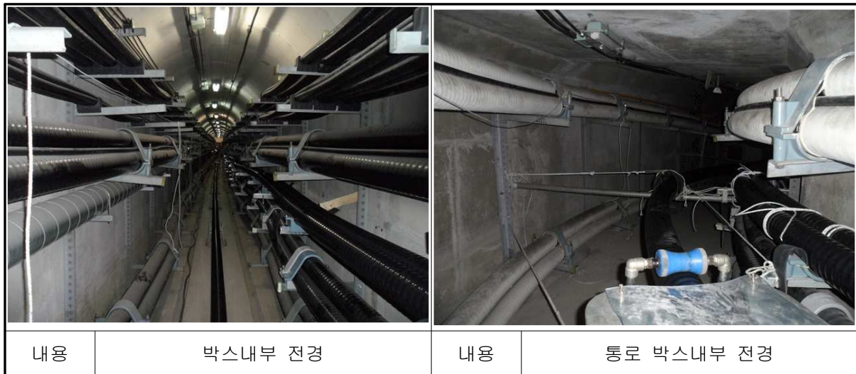
【사진 1.1】 구리인출 전력구 현황
