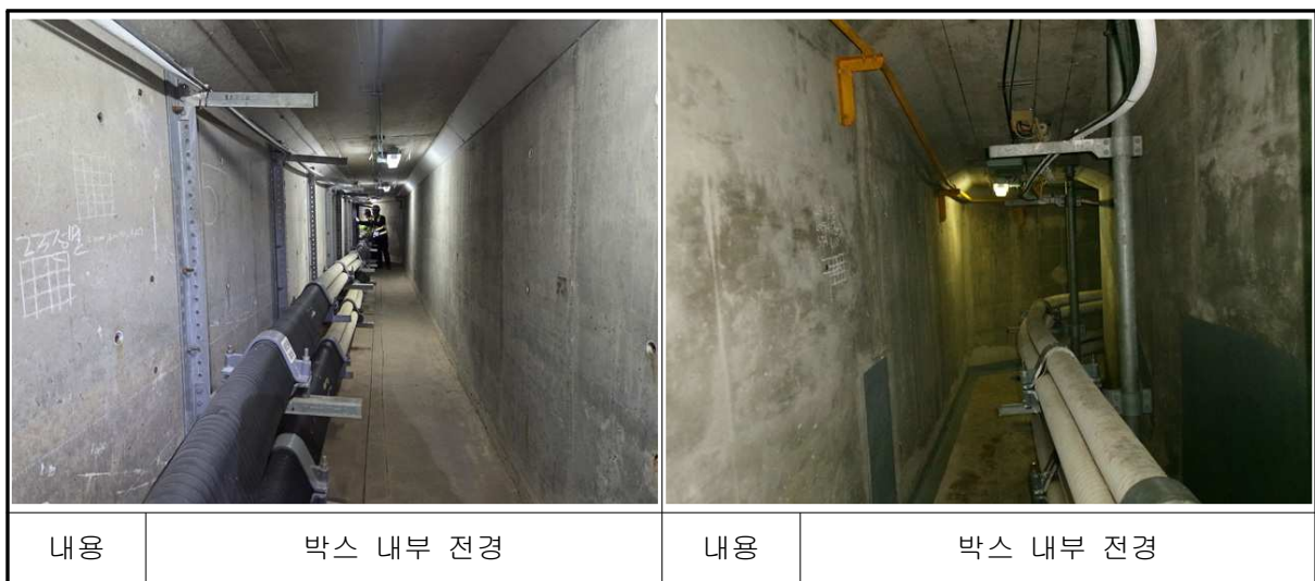
【사진 4.1】 송포일산인출 전력구 현황
